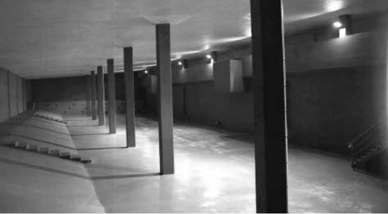
Wasserkammer im Hochbehälter Buchberg
